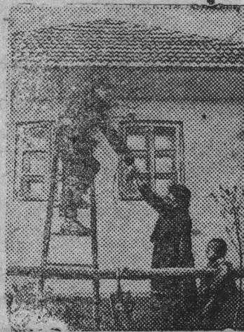
На снимке: проводка электричества в квартиру колхозницы-ударницы Натальи Савчук (Каменецкий р-н, Винницкой обл.)
